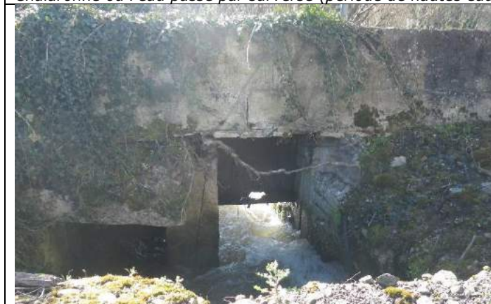
Empellement ouvert et cassé à l'amont du Moulin Neuf (avant restauration)
