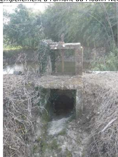
Empellement situé à l'amont du Moulin de Tallard
